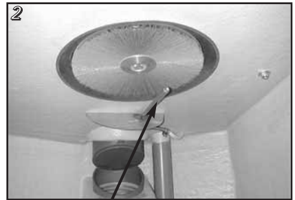
Straalpijp in de container
