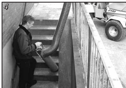
Verlengde zuigslang in gebruik
