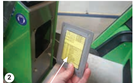
2 Sicherungsübersicht – auf der Rückseite der Sicherungsabdeckung
